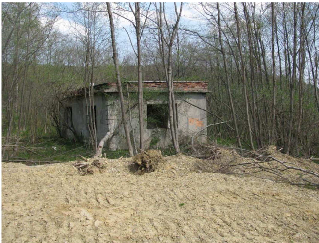
Fot. 1. Jeden z obiektów budowlanych w bardzo złym stanie technicznym, po dawnym Zakładzie Budownictwa Leśnego w Ustrzykach Dolnych
