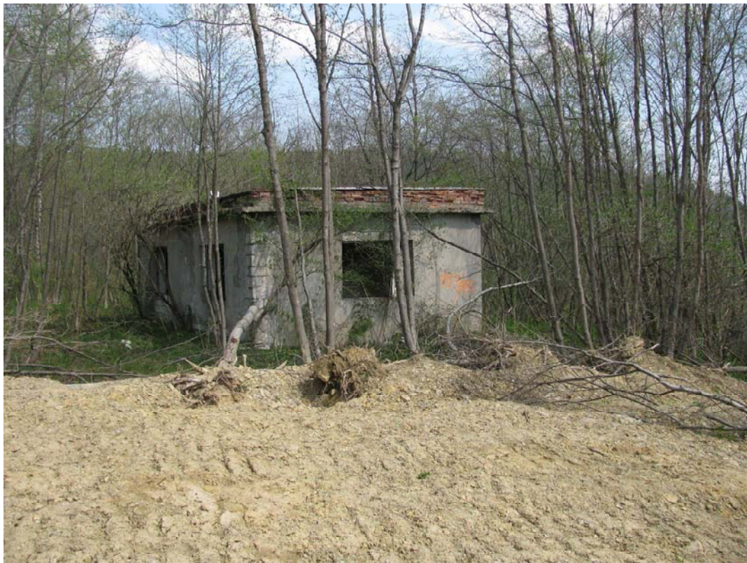
Fot. 1. Jeden z obiektów budowlanych są w bardzo złym stanie technicznym po dawnym Zakładzie Budownictwa Leśnego w Ustrzykach Dolnych
